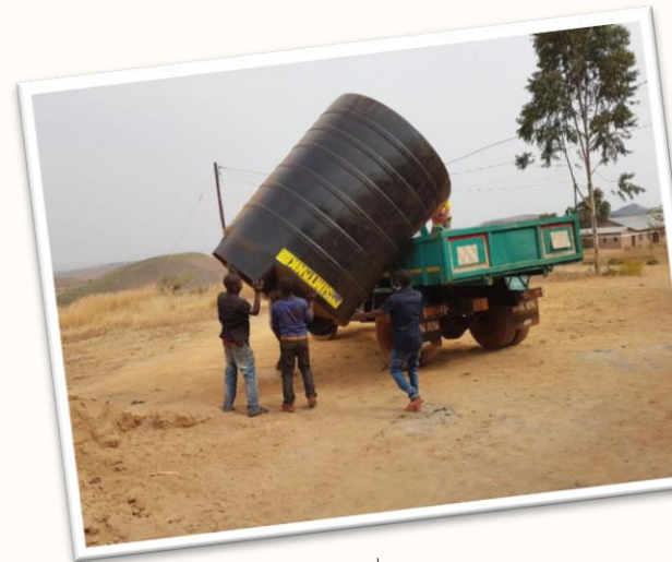
Unser erster Wassertank
